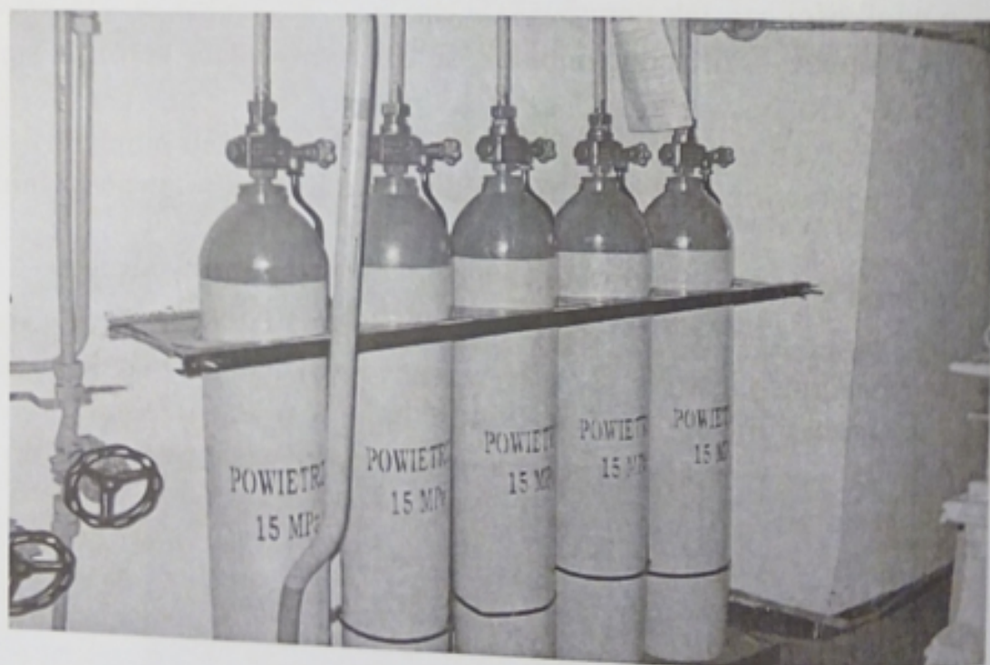
Rys. 6. Butle ze sprężonym powietrzem
