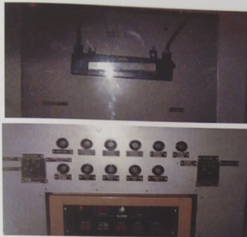
Rys. 7. Pulpit sterowania i kontroli filtrowentylacją w obiekcie
